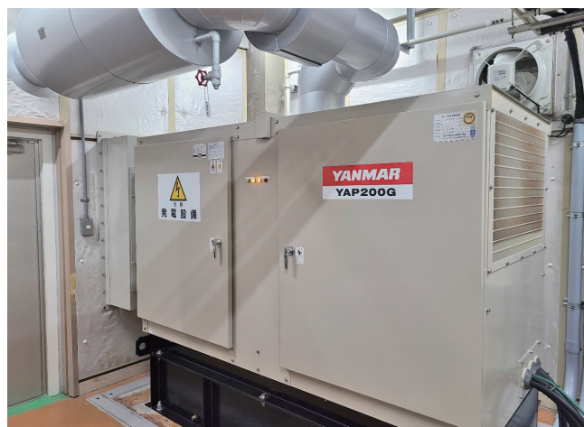
白浜水族館の非常用自家発電設備
