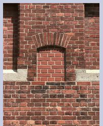
壁に残る穴の跡
