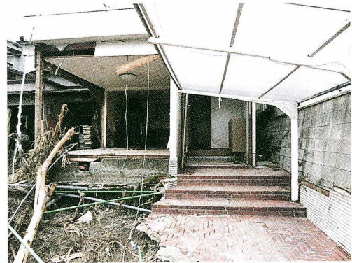
図21 泥流の通り道となった家屋（8月15日）
