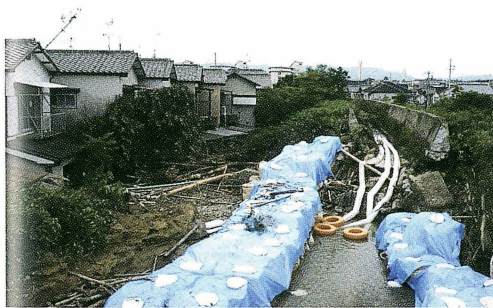
図18 弥陀次郎川の破堤箇所全景（8月15日）
