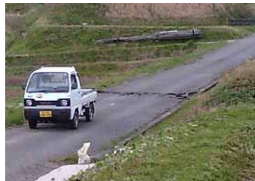
写真5 道路の地割れ
