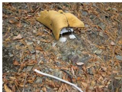
写真 4 ケーブル断線
