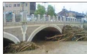
浅野川大橋の流木堆積状況(金沢市)
