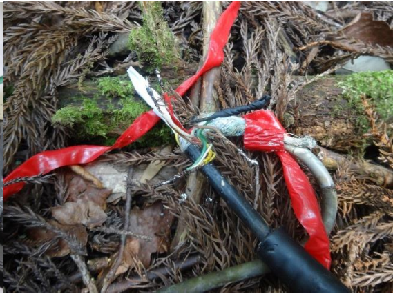
図2．地震計延長ケーブル結線箇所
