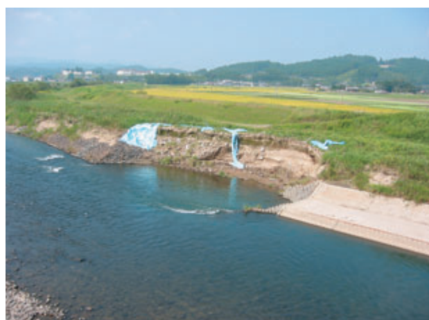
写真2 河川堤防の被災（堤防の堤外側が崩壊している）
