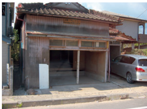
写真1 虎居地区（1階部分がほぼ浸水し、1ヶ月が経過しても家財道具等が入れない状態の家屋）
