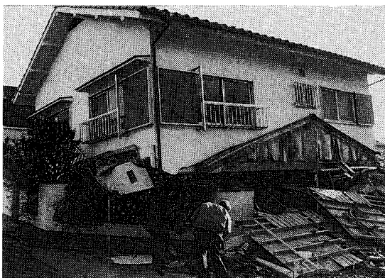
写真43 1 邸周辺地域の木造2階建住宅の倒壊例
