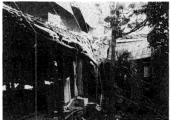
写真 2 A 邸内の傾いた木造の離れと渡り廊下
