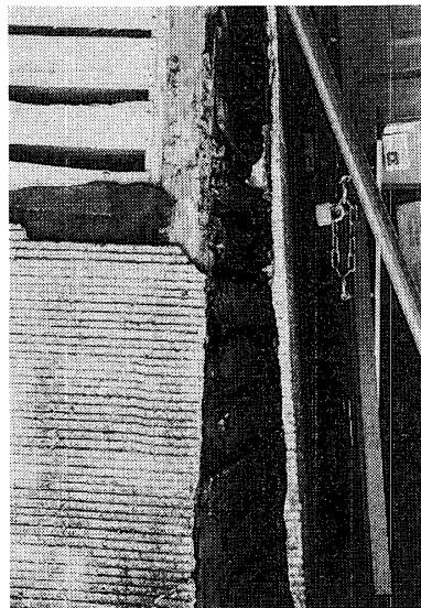
写真47 モルタル下地材の腐れと シロアリ被害の状況
