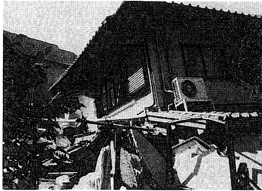
写真23 E邸の周辺地域での木造住宅の損壊状況
