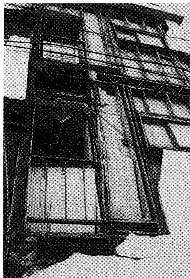
写真48 鉄骨造の木質部の腐れと シロアリ被害の状況
