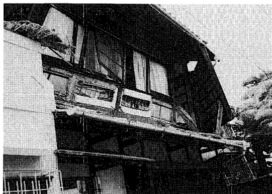
写真21 E邸の周辺地域での木造住宅の損壊状況
