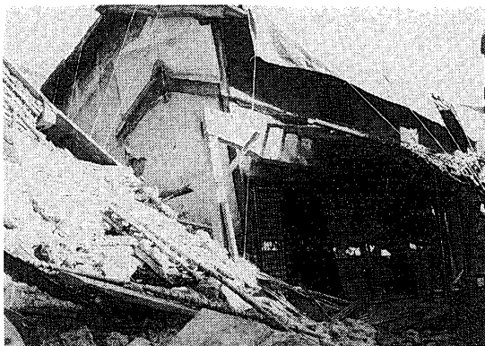
写真 1 A 邸内の倒壊した土蔵と損壊した木造の小屋
