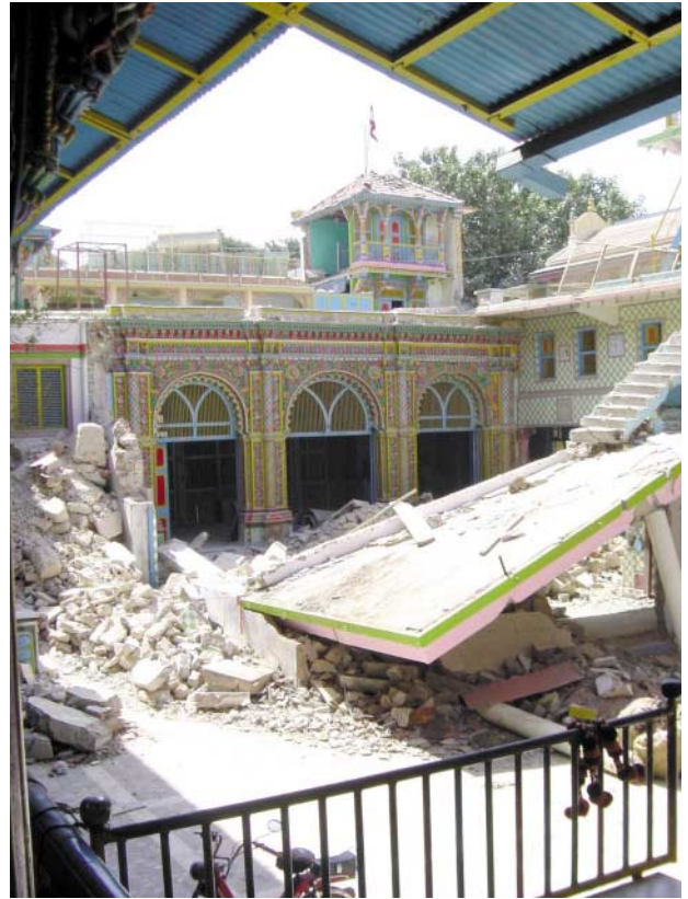
4. 被災したBhujの寺院
