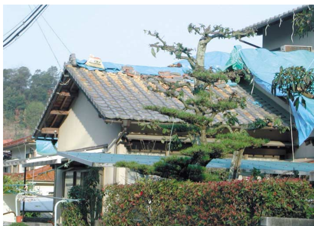
写真3 木造住宅の瓦屋根の被害（松山市）
