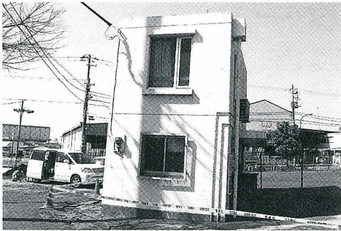
写真3 沈下・傾斜した交番（新木場）
