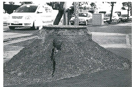
写真15 浮上ったマンホール（浦安市日の出）
