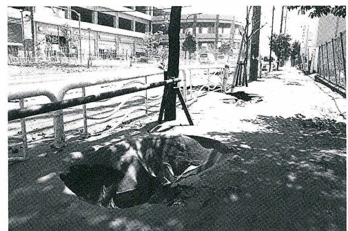
写真2 歩道を覆った噴砂（新木場）
