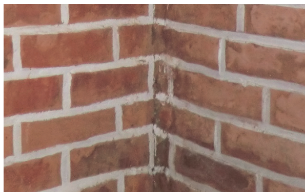
(a) D1に生じたひび割れ
