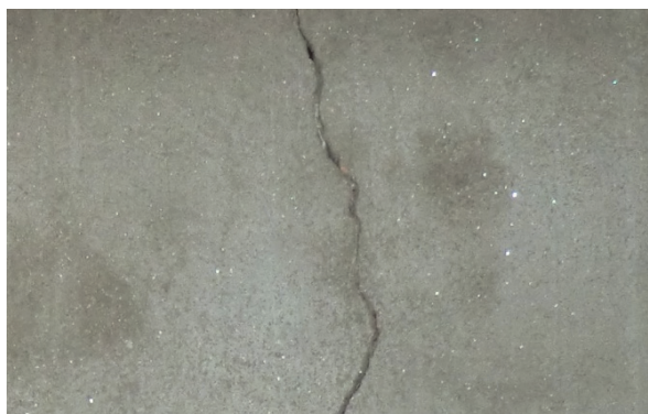
(b) D3に生じたひび割れ
