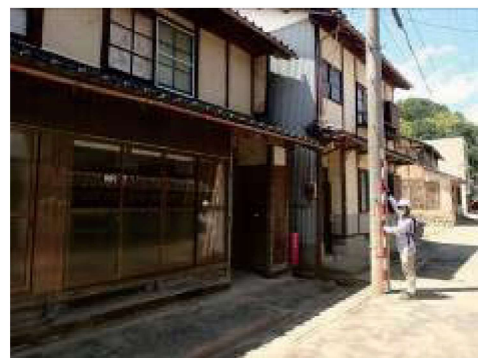
図-2 2.7mの浸水痕跡が見られた住宅
