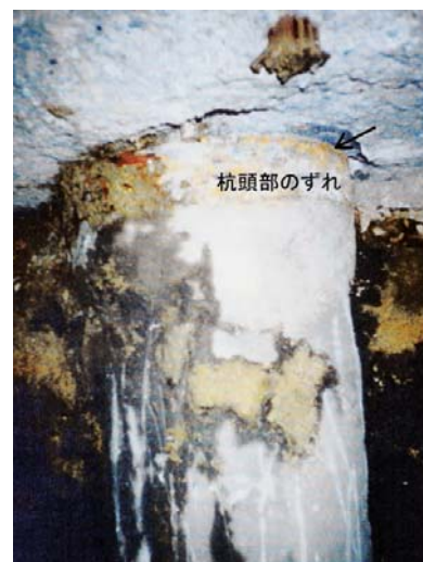
写真8 杭頭部のずれ変位
