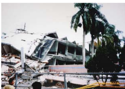
写真 4 断層に跨る建物の崩壊
