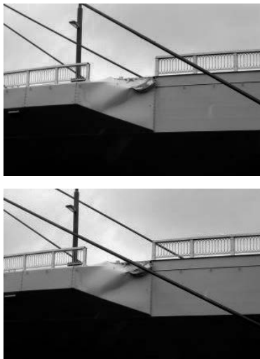
写真1 実橋ケーブルの振動事例 9)
