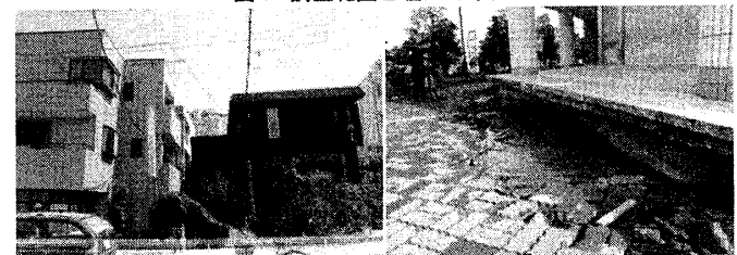
写真1 傾斜した建物
