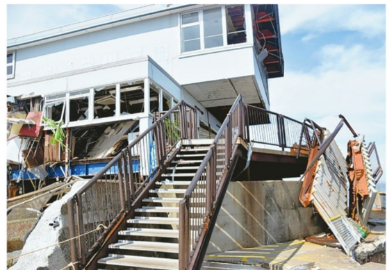
図 2：被害を受けた本牧海釣り施設。
