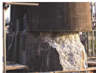
写真-1 2004年新潟県中越地震で被災した魚野川橋梁14P橋脚 3)
