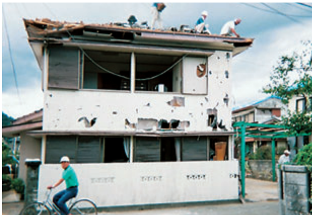
写真3 飛来物による外壁・開口部の破損
