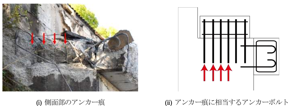
図-19 落下した横変位拘束構造の取付部側面の状況 (2016年4月16日撮影)
