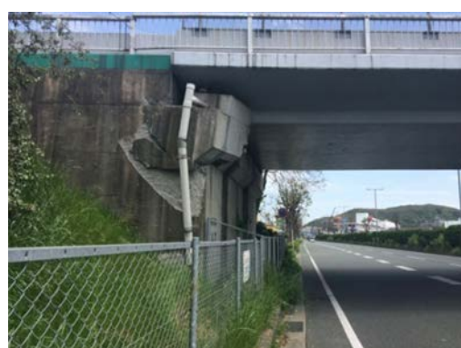
(ii) 横変位拘束構造の破壊
