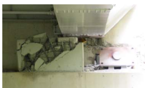
(ii) 横変位拘束構造の破壊
