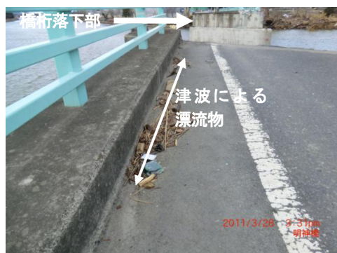
写真-5 東松島市定川大橋上の痕跡(K18)
