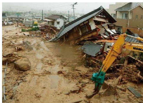
(e) 土石流による家屋被害
