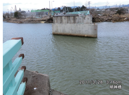
写真8 定川大橋中央桁の破壊（石巻市方向）
