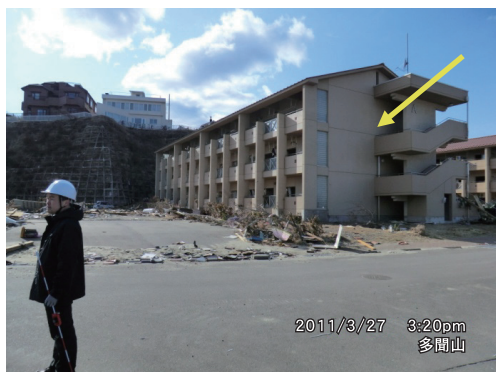
写真4 菖蒲田浜海岸付近（アパート）
