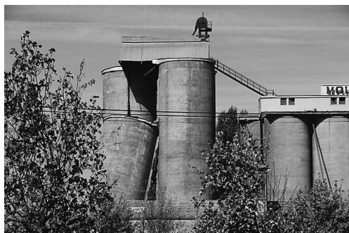
写真3 Talca 付近で見られたサイロの被害
