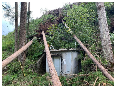
図 4. 加治木観測室の被災状況
