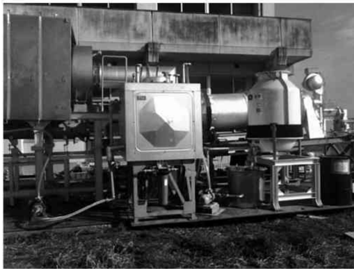
写真 1：現地に設置されたマイクロ波処理炉
