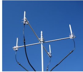
図 6 基地局アンテナ
