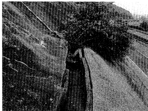
図—3 吹付けコンクリート斜面でのスライド破壊の発生状況
