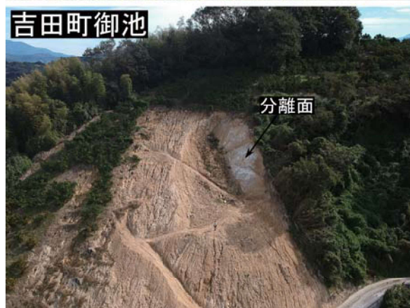
図-4 岩盤崩壊の例と大規模分離面
