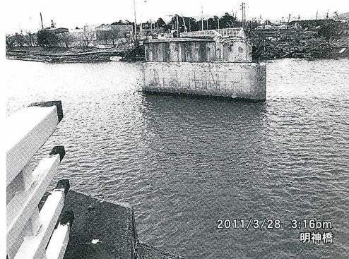
写真8 定川大橋中央桁の破壊（石巻市方向）
