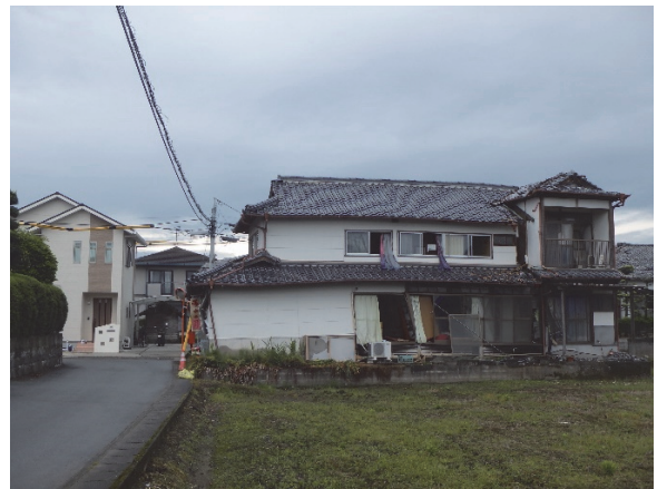
写真3：旧耐震の木造住宅の倒壊の様子2
