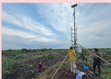
電力や通信の届かない地域における、太陽光発電によるオンライン水位観測機器の設置
