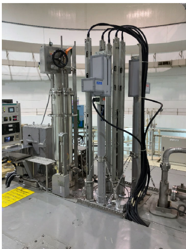
写真 6. 炉頂 制御棒駆動装置
