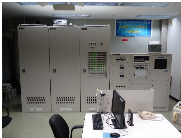
写真 5. 制御室 警報表示等
