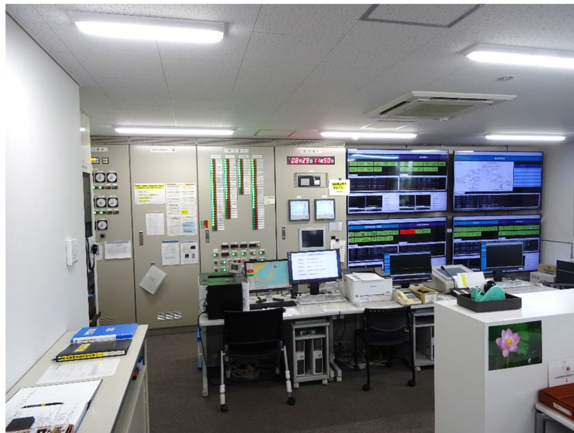
写真 9. 2023 年に新設された中央管理室
