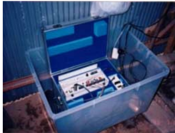
写真 8 有線テレメータ送量装置
