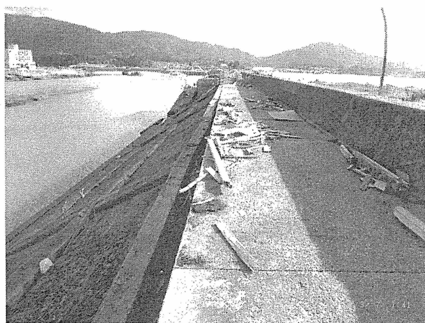
写真 3.3.13 高田松原の僅かに損傷した防潮堤
