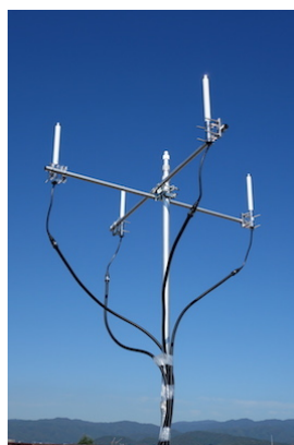
図 4 基地局アンテナ
