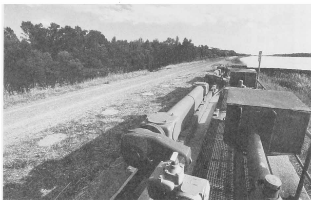
ライン川の上流、ドイツでの洪水調節ポンプ。洪水が堤防を越える前に、ポンプのスイッチを入れ、川の水を農地へと流す。
