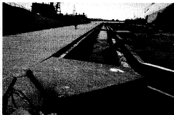
図-2 気仙沼港の桟橋式岸壁：渡版の流失
