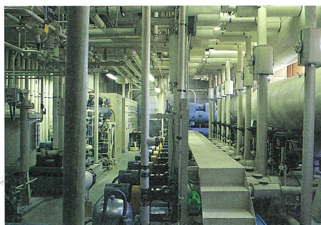
機械室内部 (右側の大きなタンクがブラインヘッダー)
