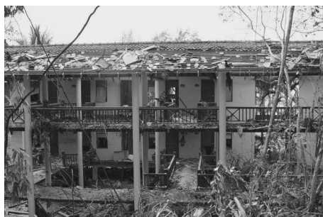
写真1 津波による家屋の被害、カオラック 出所：本多潔（AIT）提供
