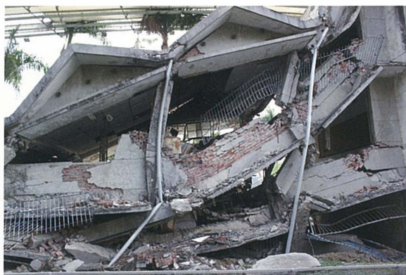
921 地震教育園区内にある崩れた校舎
