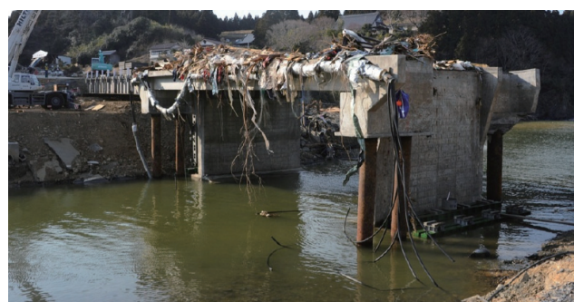
写真8 橋梁の裏込土の流出
