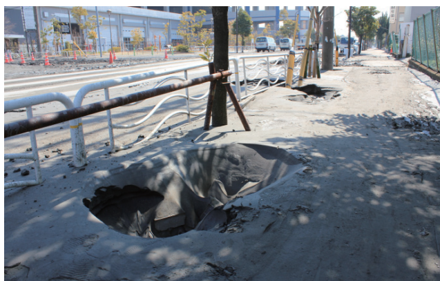
写真1 歩道に堆積した噴砂
