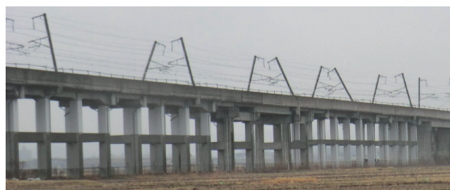
写真3 新幹線電化柱の損傷
