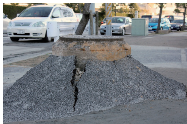
写真7 浮上ったマンホール
