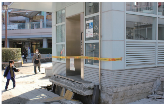
写真2 周辺地盤の沈下による段差
