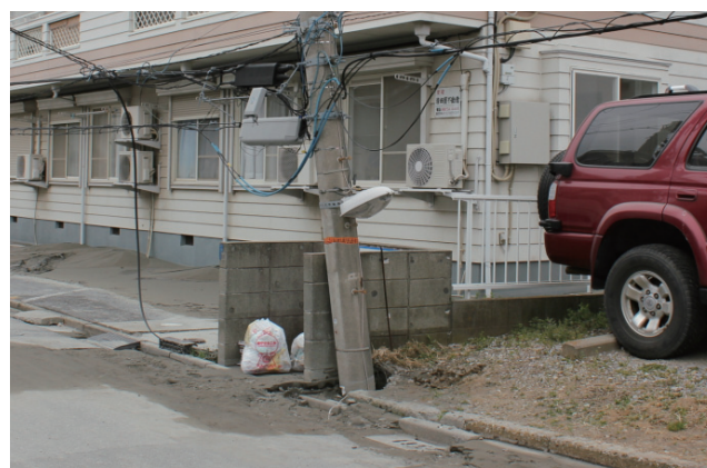
写真6 沈下した電信柱
