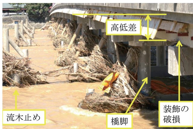
写真1 流木がひっかかった渡月橋（9月20日）
