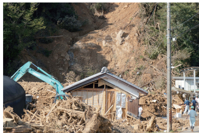
写真 4 栗東市下戸山地区の斜面崩壊（9 月 21 日）
