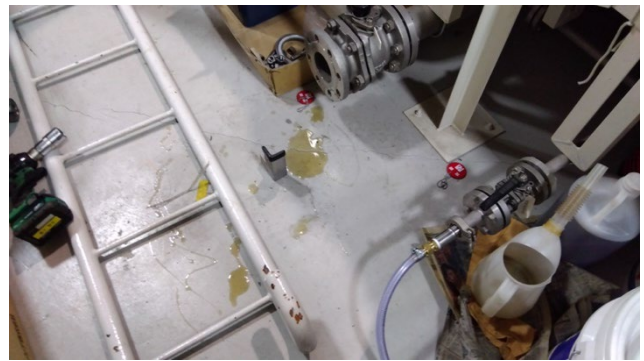
図8 ガスバッグ入口配管からの油漏れ
