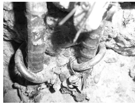
図-17 フック部が開かずに軸方向鉄筋の座屈に抵抗している様子
