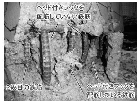
図-22 C100-WHの軸方向鉄筋の座屈発生後の様子
