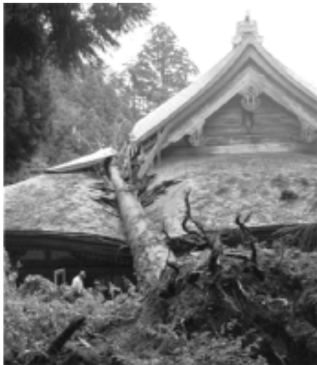
台風 9907 号による歴史的建造物の被害
