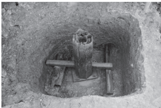
図1 平城宮跡東院庭園隅楼の柱と地中梁。柱の上部は腐朽が進行しているが、柱の下部、地中梁、礎板等、下層にある部分は腐朽の程度は軽い。
