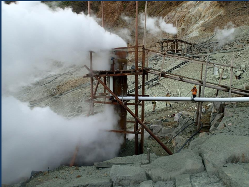
噴気異常が認められた蒸気井(第39号井)
