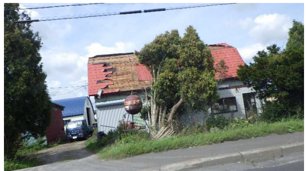
写真 2.1.5.6 農業施設の屋根被害（恵庭市）
