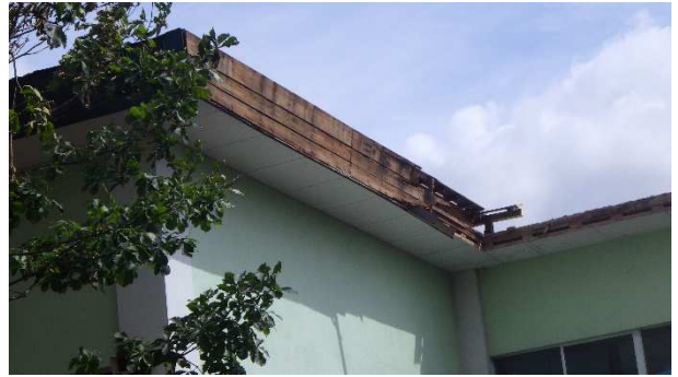
写真 2.1.5.2 小学校の屋根被害（恵庭市）
