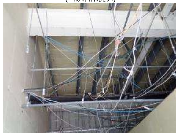
写真 2.2.1.42 倉庫・事務室での天井の脱落
