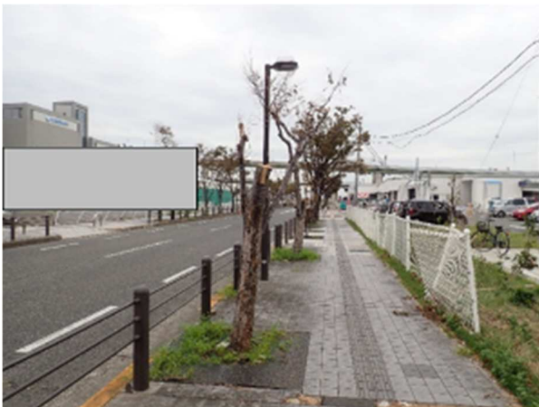
写真 2.2.1.76 街路樹の折損（折損範囲を切断済み）
