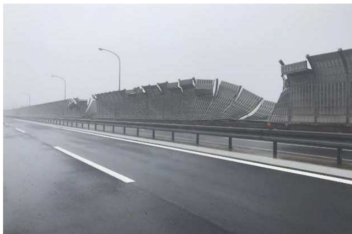
写真 2.2.6.1 遮音壁の損傷
