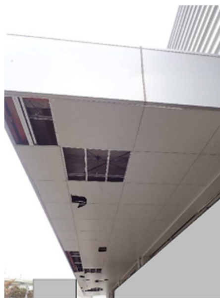
写真 2.2.1.48 軒天井の損傷 1
