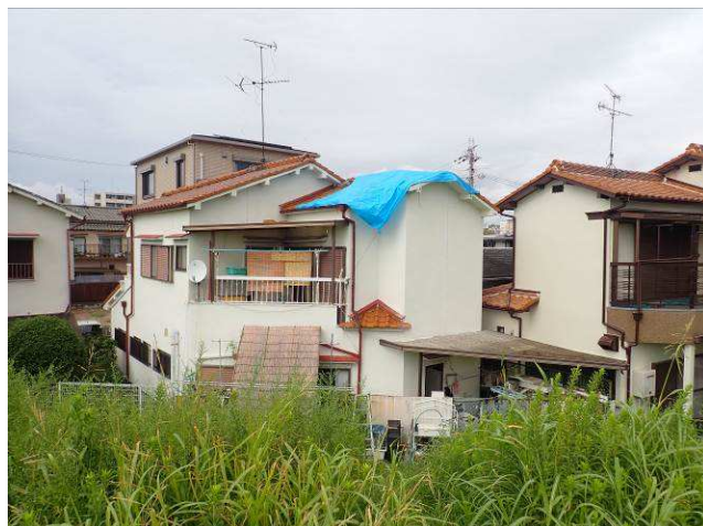
写真 2.1.4.4 尼崎市の住家の屋根葺き材の被害
