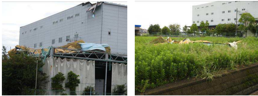
図 2.2.3.3 物流倉庫の折板屋根の被害（高槻市）
