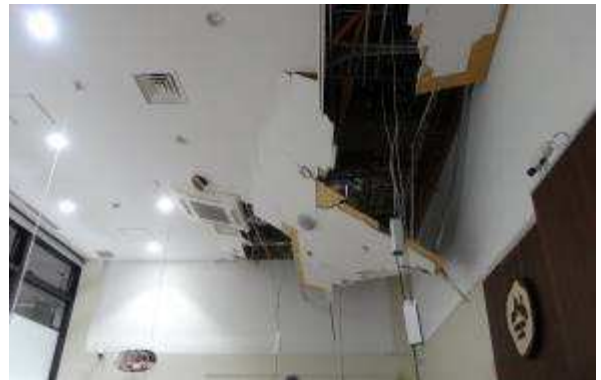
写真 2.2.1.4 1階店舗の天井の被害
