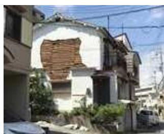
住宅①木造壁のはく落
