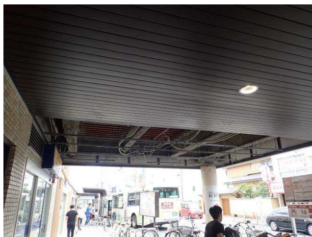
写真 2.1.4.7 軒天井の被害（阪急園田駅）
