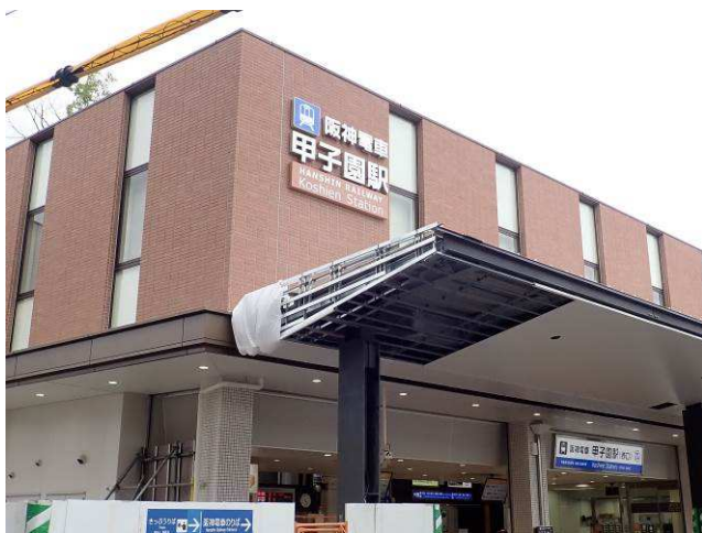
写真 2.1.4.6 軒天井の被害（甲子園駅）
