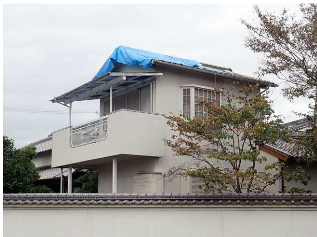
写真 2.1.4.3 伊丹市の住家の屋根ふき材の被害
