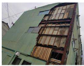
住宅②ALC 壁のはく落
