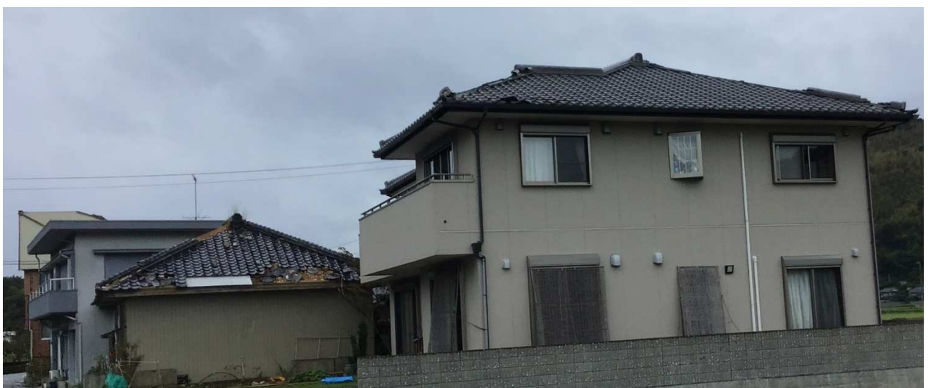
図 2.1.2.4 屋根の被害（図 2.1.2.3 中，地点ア）
