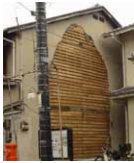
a. A collapsed wall
